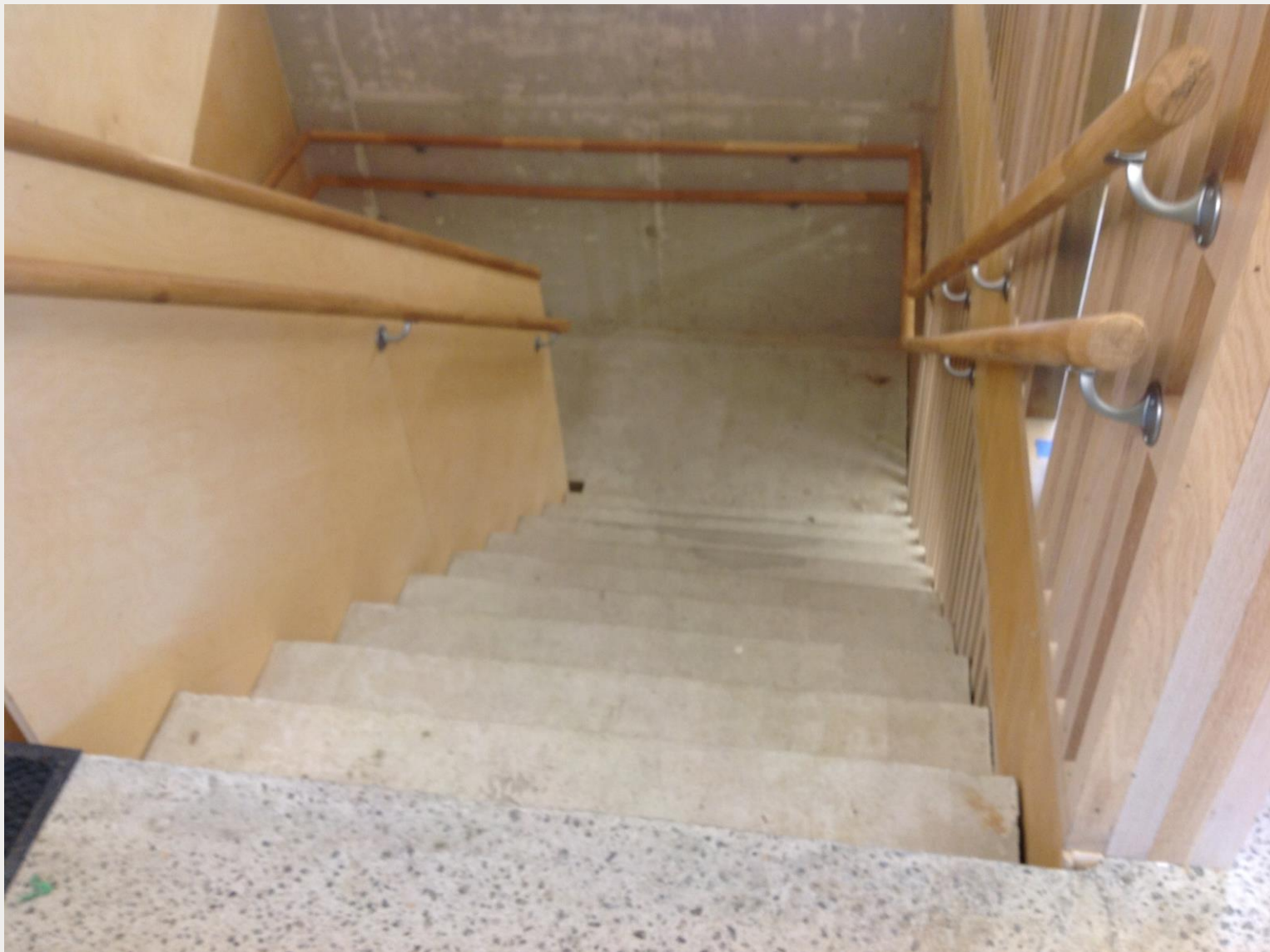
Trapp uten markering av trinn og farefelt.
